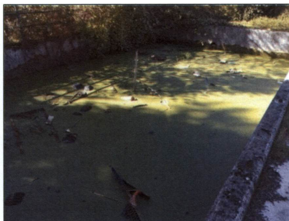
Residuos en el interior de la balsa de decantación.
